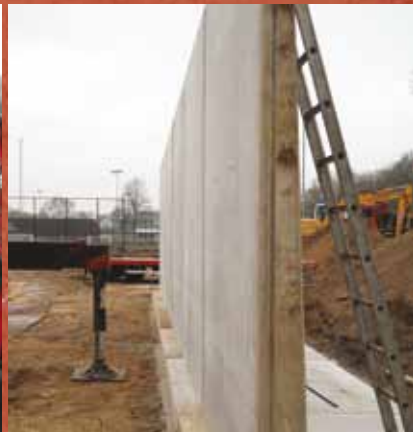
Met behulp van afstandbediening en handwerk zijn ze met een kraan op de juiste plek gezet.
